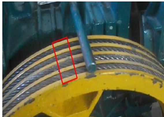
Imagen 2 polea tractora de ascensor
